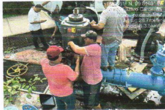
OBRA TERMINADA MOTOR 200 HP
