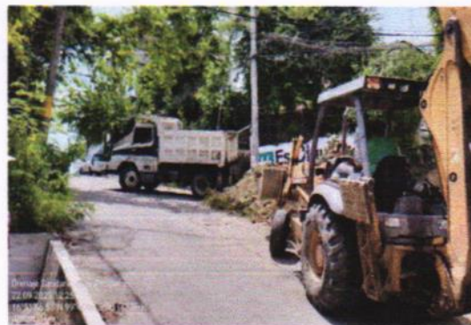
CARGA CARGA MECANICA Y ACARREO
