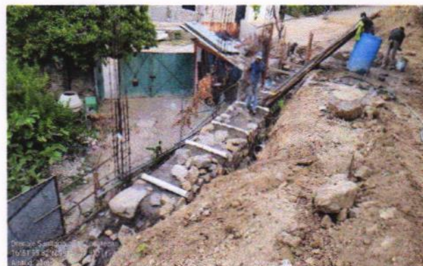
18-0313 DREN PARA MURO DE MAMPOSTERIA
