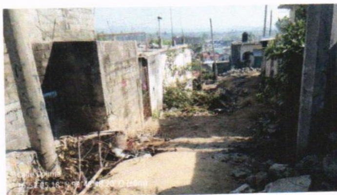
OBRA SIN ACTIVIDAD POR HURACÁN OTIS
