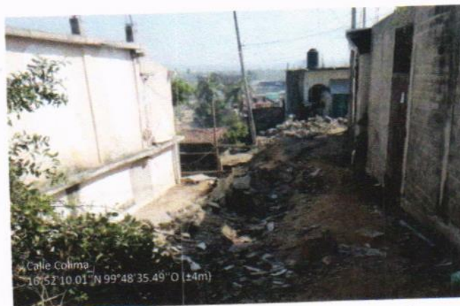
OBRA SIN ACTIVIDAD POR HURACÁN OTIS
