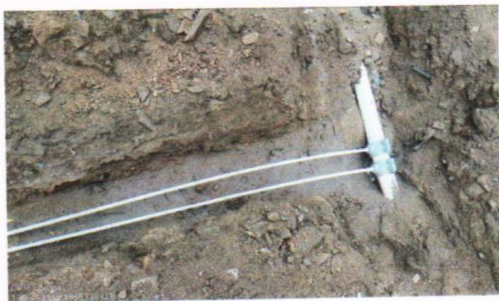
TOMAS DOMICILIARIAS DE 13MM CON CPVC
